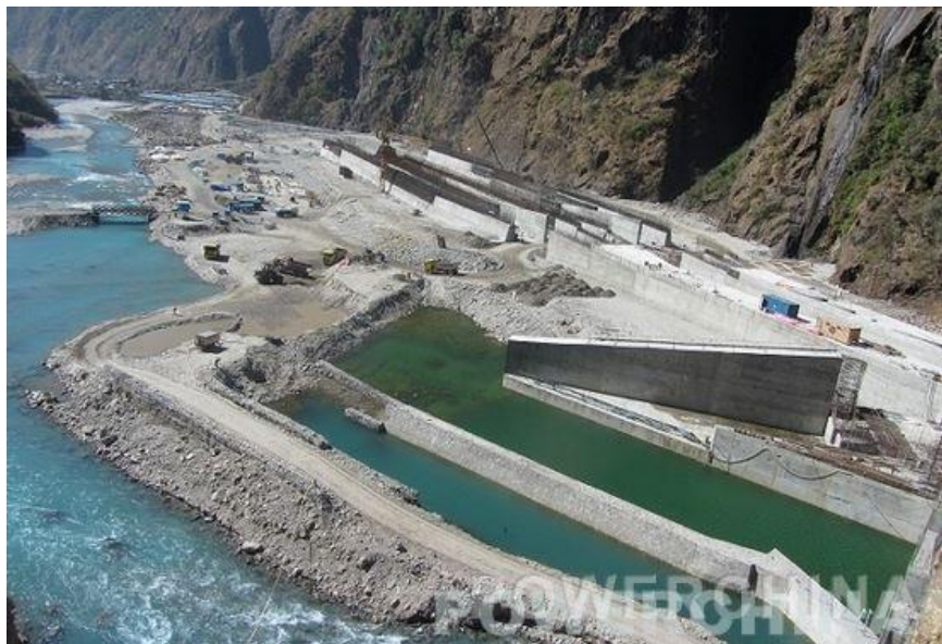
中国水电建设集团国际工程有限公司承建的上塔马克西水电站
